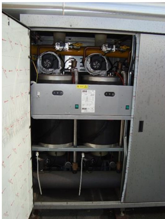
Figura 4.10 - Caldaia a condensazione
