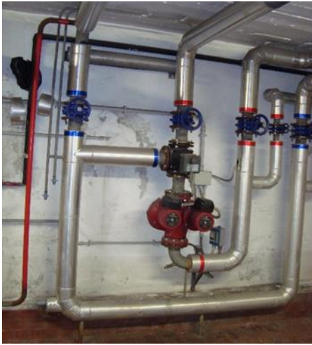
Figura 4.6 - Particolare della valvola a tre vie sul circuito
