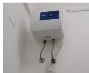
Figura 4.12 - Boiler elettrico produzione ACS
