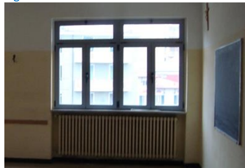
Figura 4.5 - Particolare installazione radiatori
